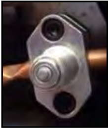
Vanne de piquage de conduite de réfrigération
