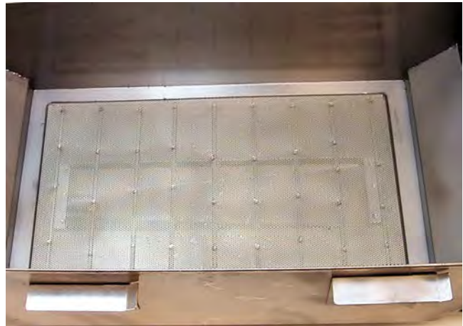
Grille de support correctement placé dans le bac de filtre.
