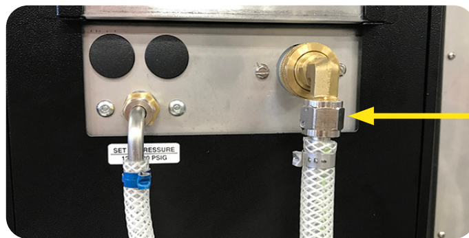
Branchement de l'eau
